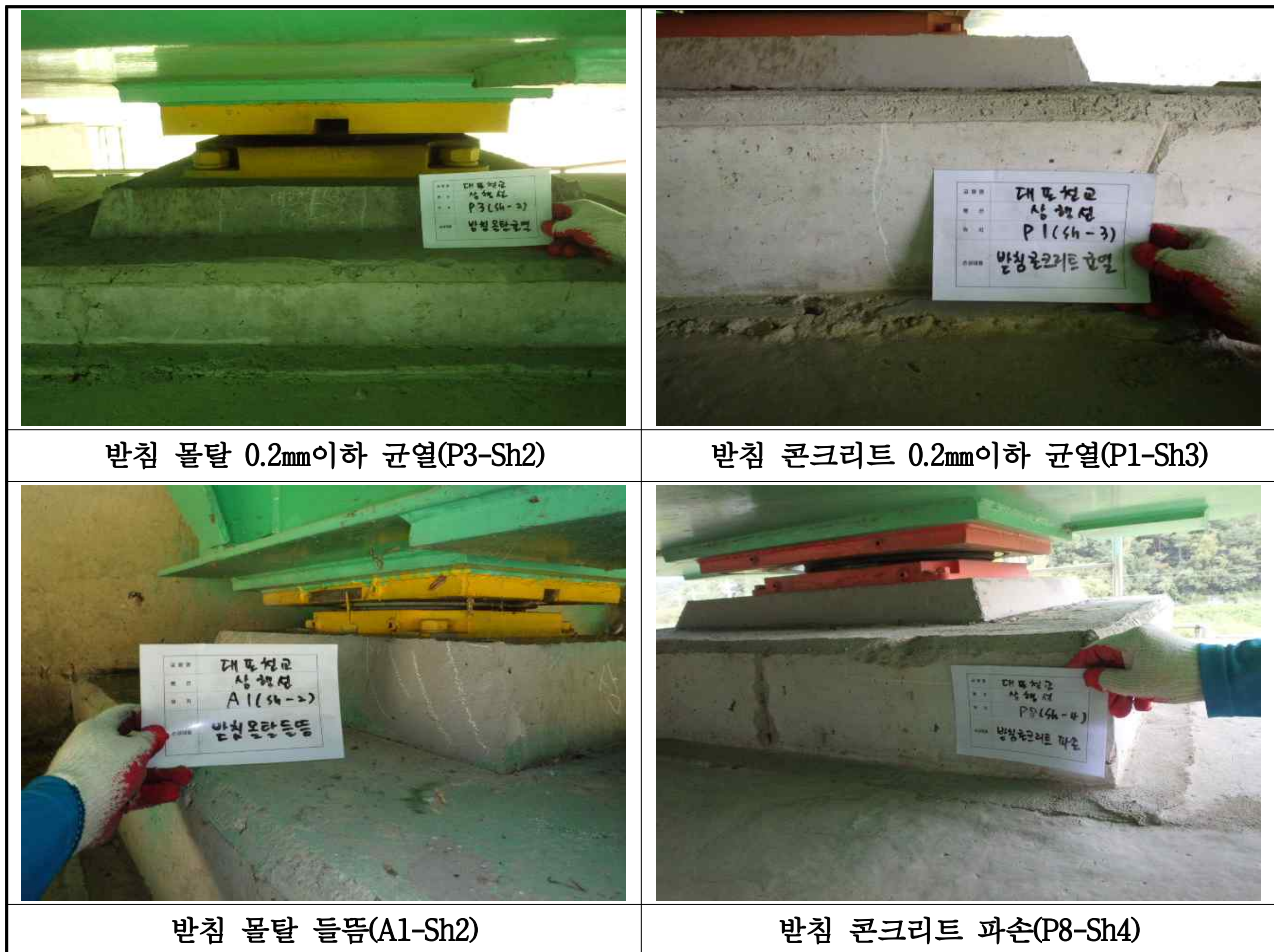
【사진 3.2.13】교량받침 손상현황(대구)
