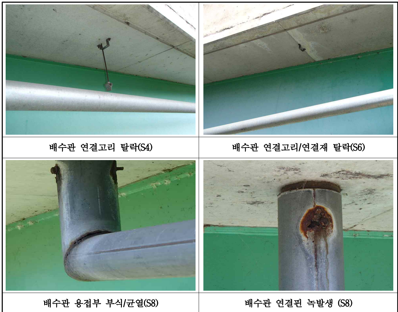
【사진 3.3.20】 배수시설 손상현황(부산)
