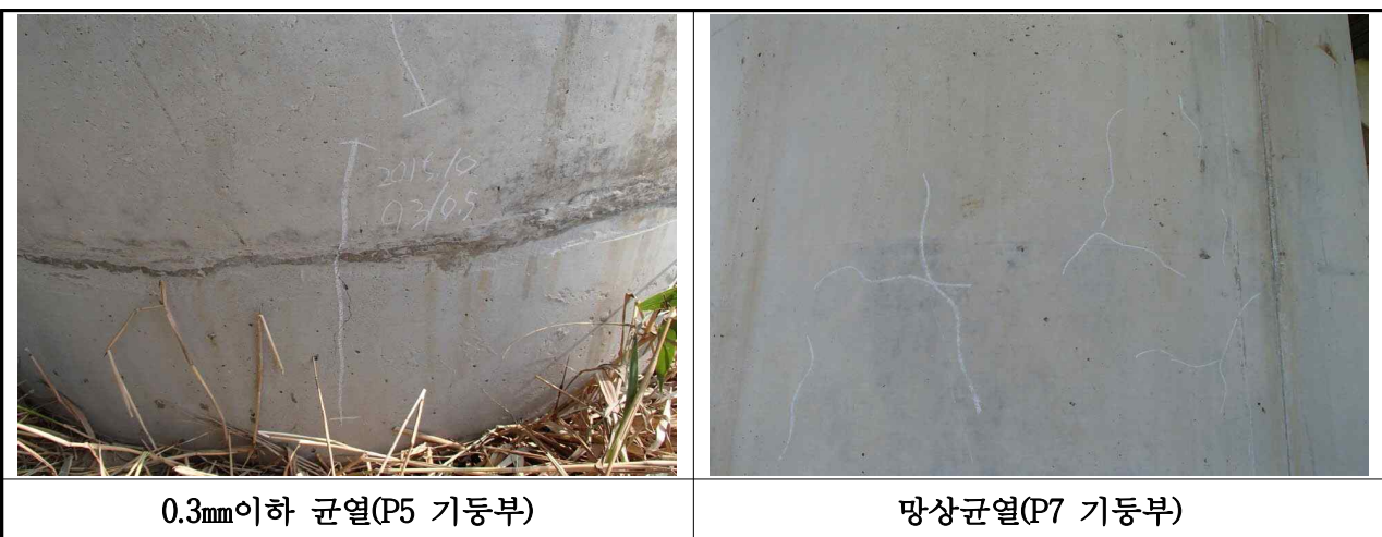
【사진 3.3.10】 교각 손상현황(부산)
