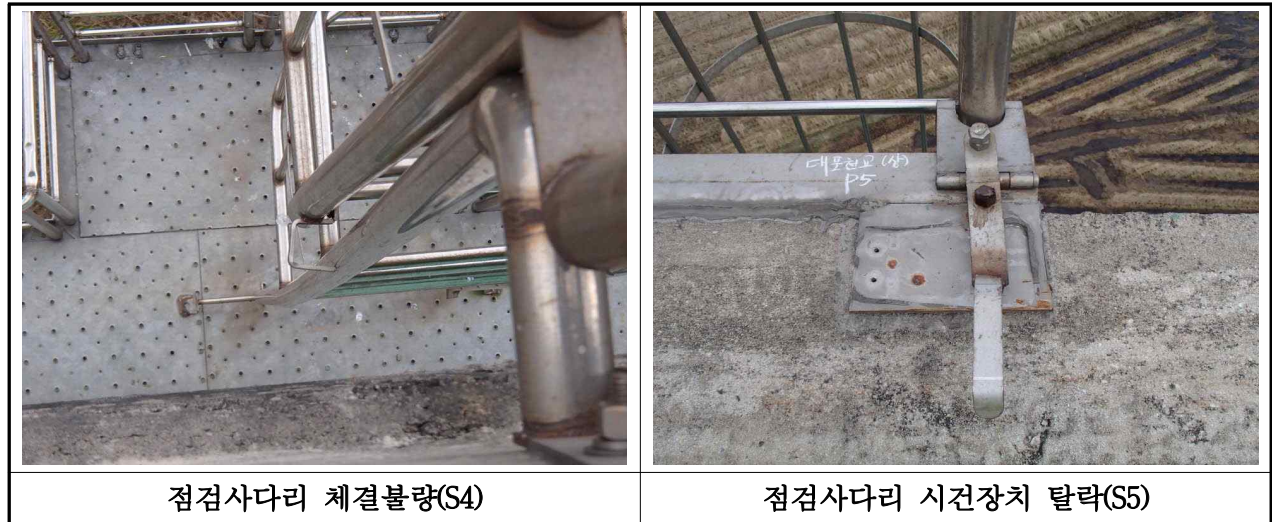
【사진 3.2.23】 기타 시설 손상현황(대구)
