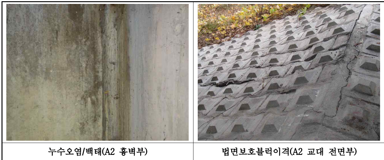
【사진 3.2.8】 교대 손상현황(대구, 계속)
