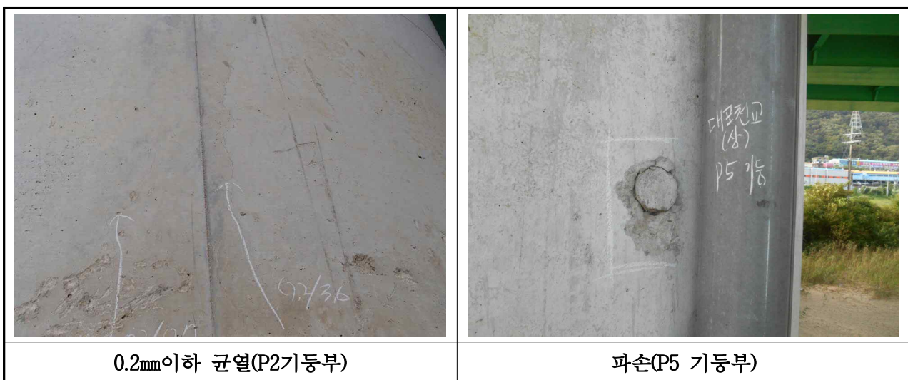
【사진 3.2.10】 교각 손상현황(대구)
