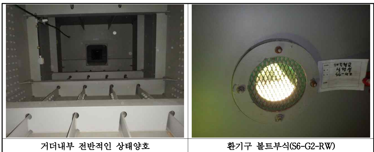
【사진 3.2.4】 강박스 거더 내부 손상현황(대구)
