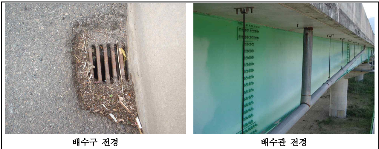
【사진 3.2.19】 배수구 및 배수관 전경(대구)
