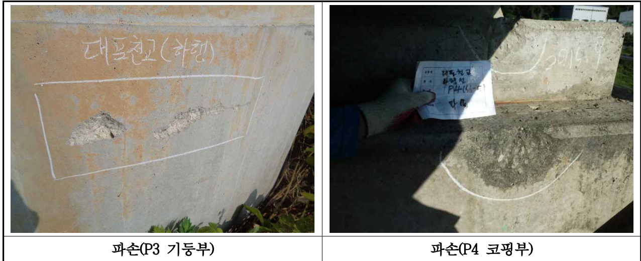
【사진 3.3.10】 교각 손상현황(부산, 계속)
