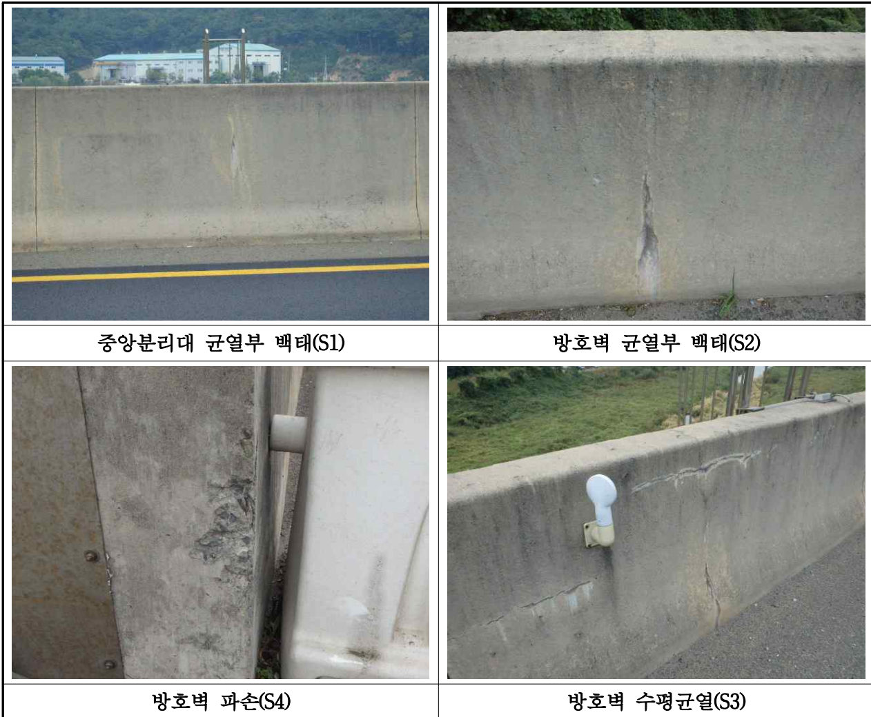
【사진 3.3.22】 방호벽 및 중앙분리대 손상현황(부산)
