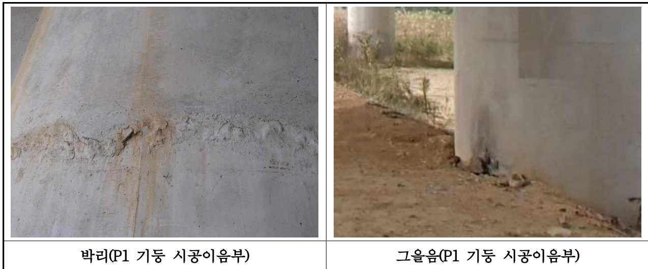
【사진 3.2.10】 교각 손상현황(대구, 계속)
